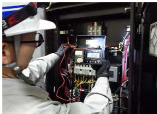
【電気設備保守・点検】
